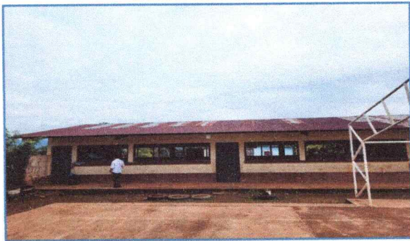
Foto 1: Se observa el deterioro de las laminas de las aulas del modulo 1.
