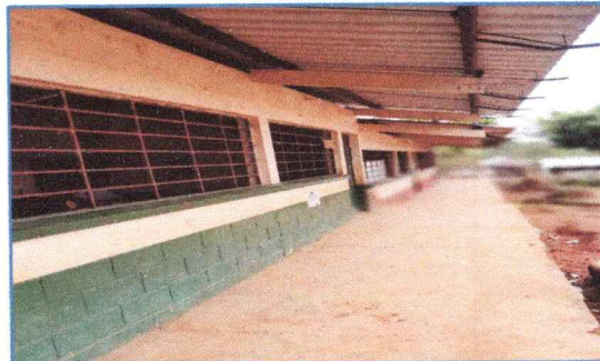
Foto 4. Se observa el mal estado y el de los balcones de las aulas del modulo 2.
